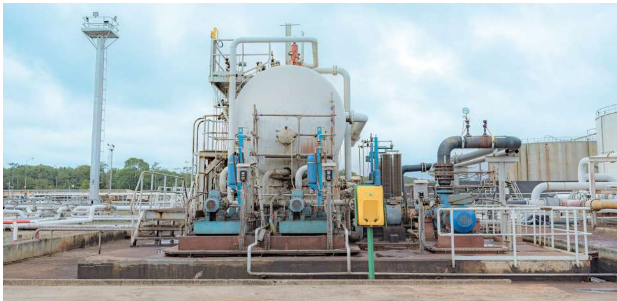
Unité ISF-2 au Terminal de Gamba.
