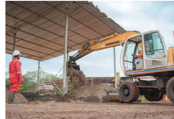
2 Des nutriments sont ajoutés et aérés pour améliorer l'efficacité du processus de traitement.
