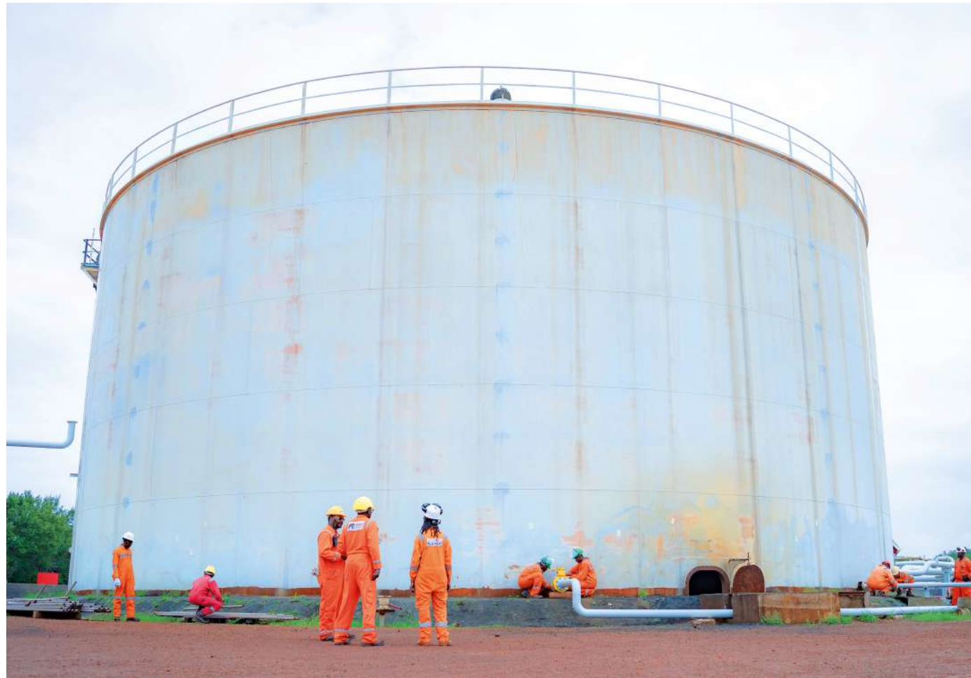
Inspection et maintenance du T3401 au Terminal de Gamba.
